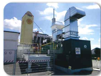
水素発電設備設置例 (ドイツ)
